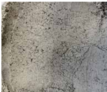
Иллюстрация 1. Общий вид пробы бетонной смеси: полное отсутствие крупного заполнителя. Фото Д. Н. Галиева. Апрель 2018 г.
