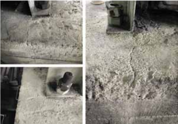
Иллюстрация 9. Характерные трещины, обнаруженные на поверхности фундаментов приводов ротора. Автор фото А. В. Куршпель. Август 2019 г.
