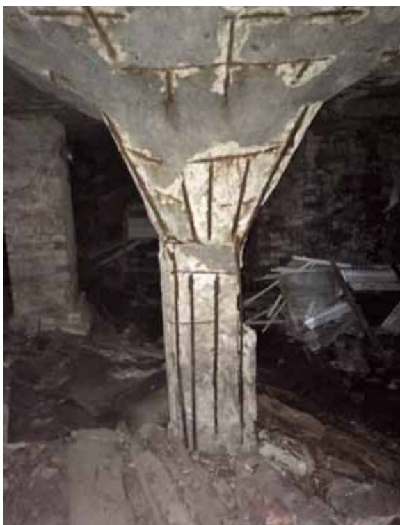
Иллюстрация 2. Колонна в подземной котельной у дома в Екатеринбурге, пр. Ленина, 69, корп. 14. Фото: В. Е. Еремеев. 2019 г.
